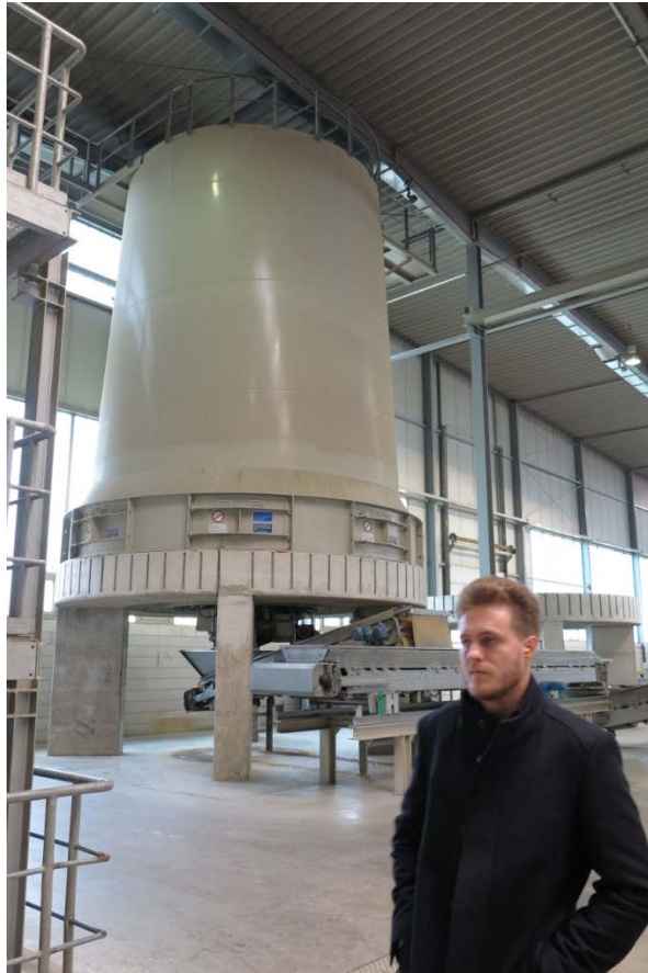
Kleiner Maukturm als Zwischenpuffer für Ton
